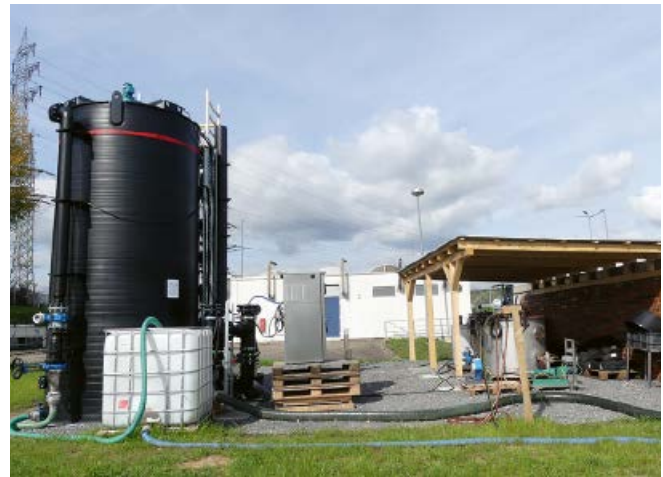
Abb. 2: Pilotanlage zur Untersuchung des PAK-SBR-Verfahrens
