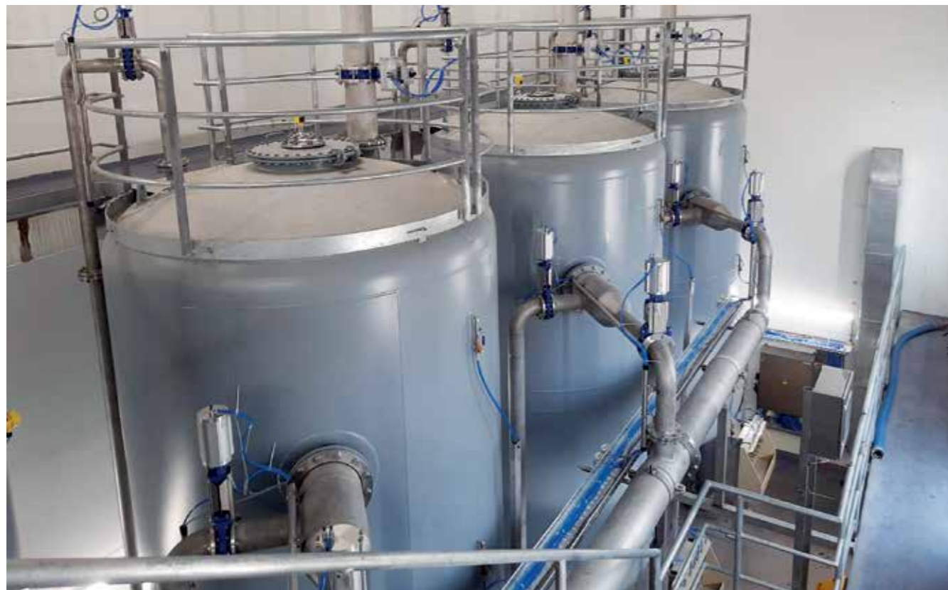
GAK-Filterkessel am Klärwerk Darmsheim
