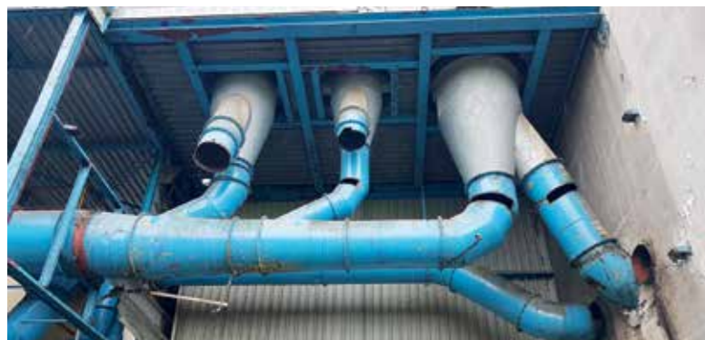
Rohrleitungen mit KMF-Dämmung unter Blechkaschierung
