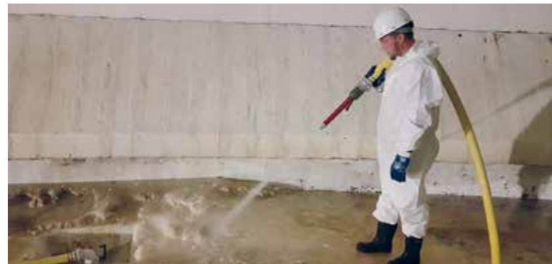
Reinigung Silosohle von Zuckerresten
