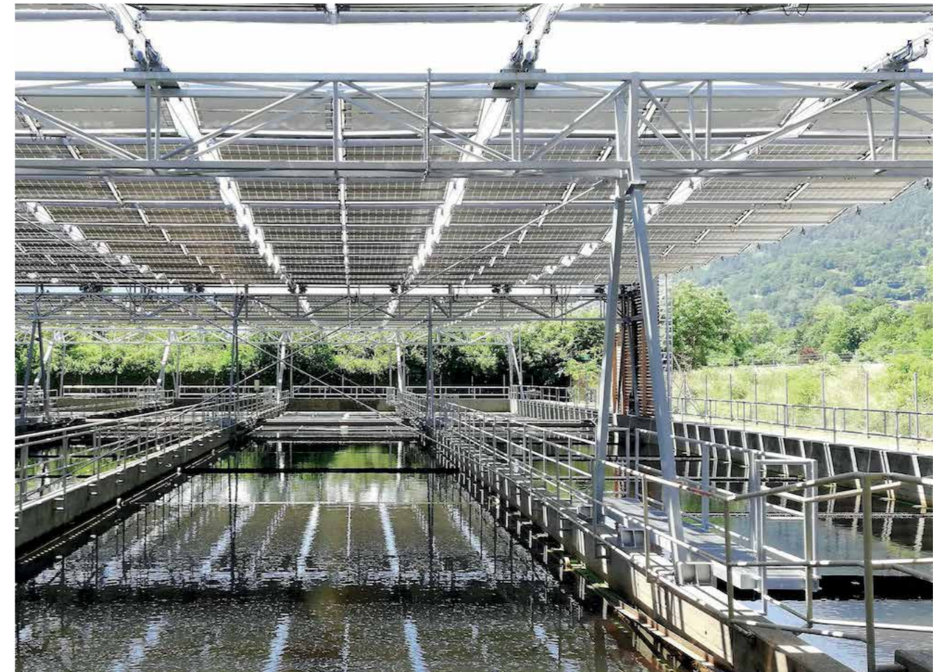
Solarfaltdach auf einer Kläranlage oberhalb einer Beckeneinheit; Bildquelle: dhp technology AG, Schweiz
