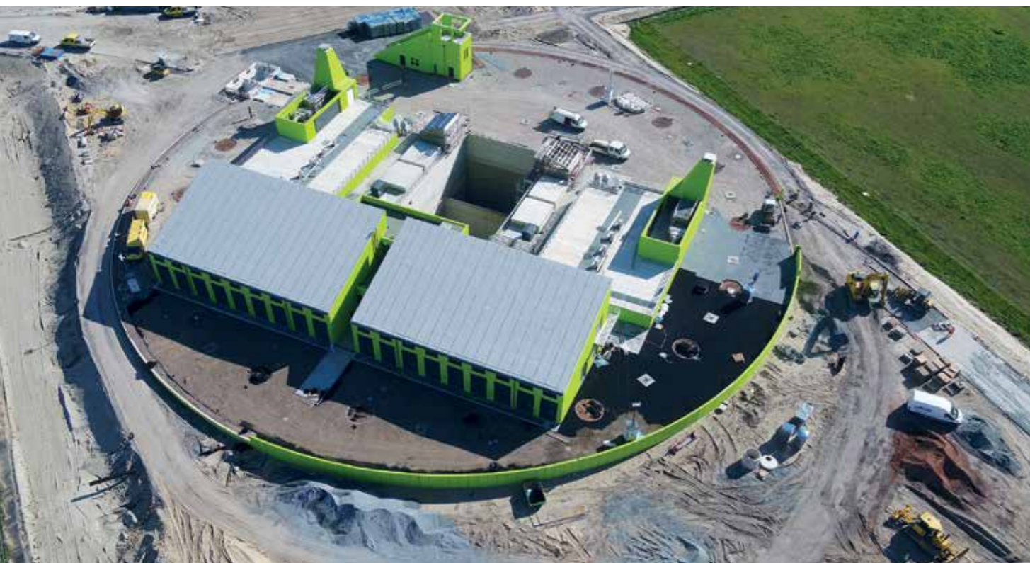
Luftaufnahme des Pumpwerks Oberhausen, Bildquelle: Emschergenossenschaft/ Lippeverband
